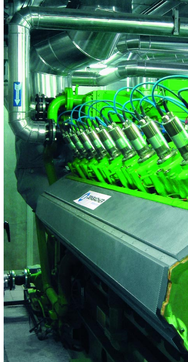
Bild 1: Strom- und Wärmeversorgung mit zwei Motoren der Baureihe 4 im Krankenhaus in Padua/Italien. Figure 1: Production d'électricité et de chaleur avec deux moteurs de la série 4 à l'hôpital de Padoue/Italie.
